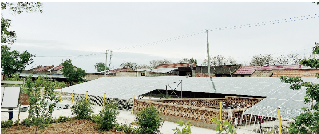
图为芮城县陌南镇庄上村的光伏屋顶
