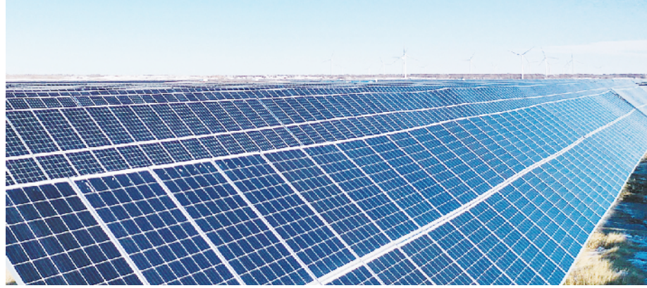
位于吉林省通榆县的光伏电站
