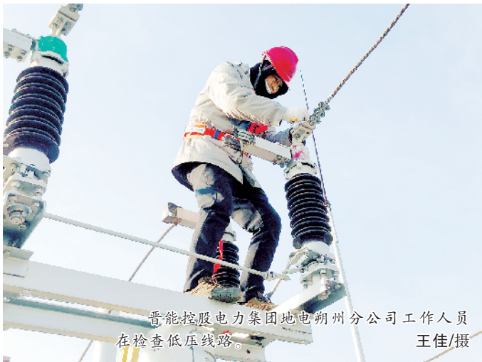
晋能控股电力集团地电朔州分公司工作人员在检查低压线路。王佳/摄
