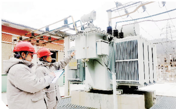
晋能控股电力集团地电方山分公司工作人员在变电站进行常规巡视。任文/摄
