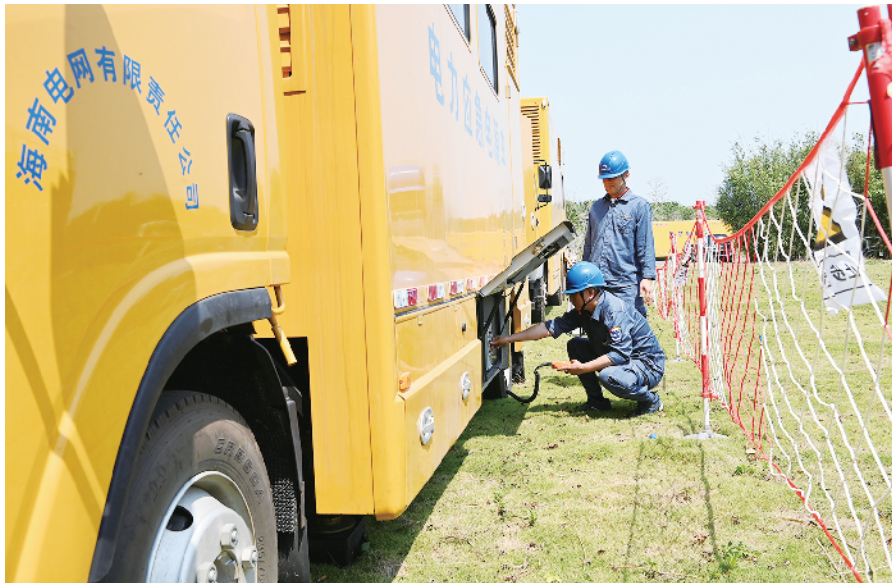
为确保博鳌亚洲论坛2023年年会100%使用绿电，南方电网推动中远博鳌公司与中广核公司达成绿证购买协议。图为前来博鳌支援的海南电网公司儋州供电局供电人员正在对应急发电车接入做最后检查，确保博鳌亚洲论坛2023年年会保供电万无一失。 赖增鹏/摄
