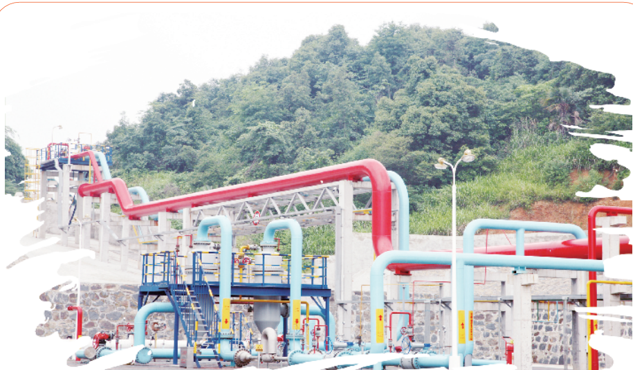
中国石化巴陵—长岭氢气输送管线全长42公里，是目前国内已建成的最长氢气输送管线。中国石化/供图
