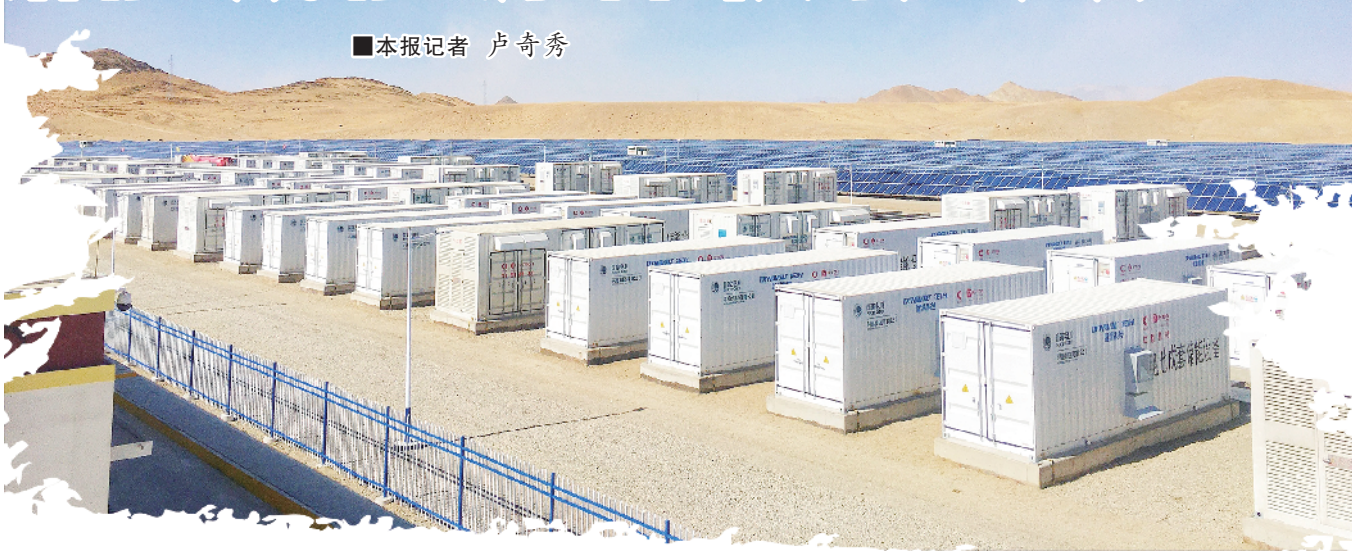
科华数能西藏日喀则40MW 200MWh光储项目。科华数能/供图
