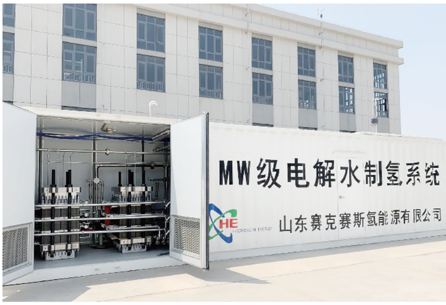
山东赛克赛斯氢能有限公司首套兆瓦级 PEM 制氢系统开机运行。
