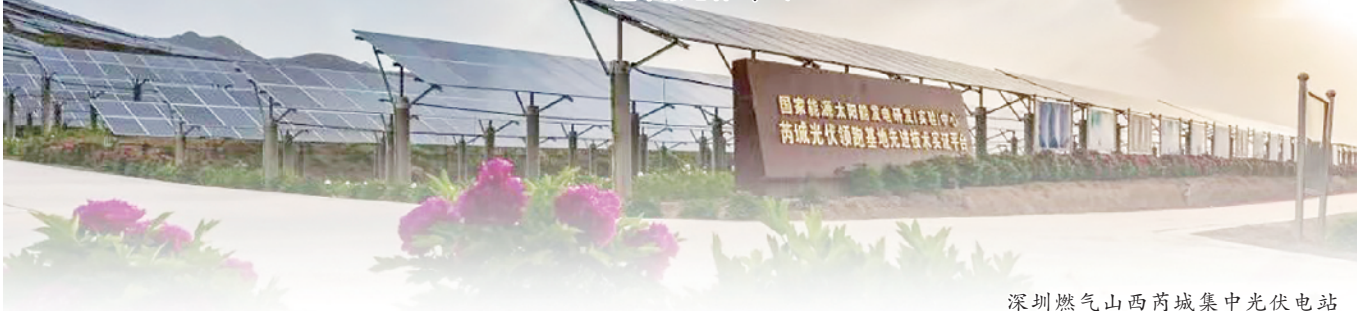
深圳燃气山西芮城集中光伏电站
