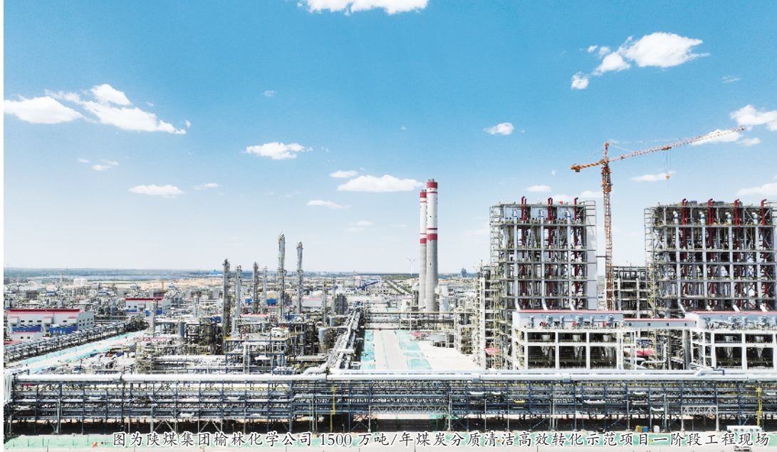
图为陕煤集团榆林化学公司1500万吨/年煤炭分质清洁高效转化示范项目二阶段工程现场。
