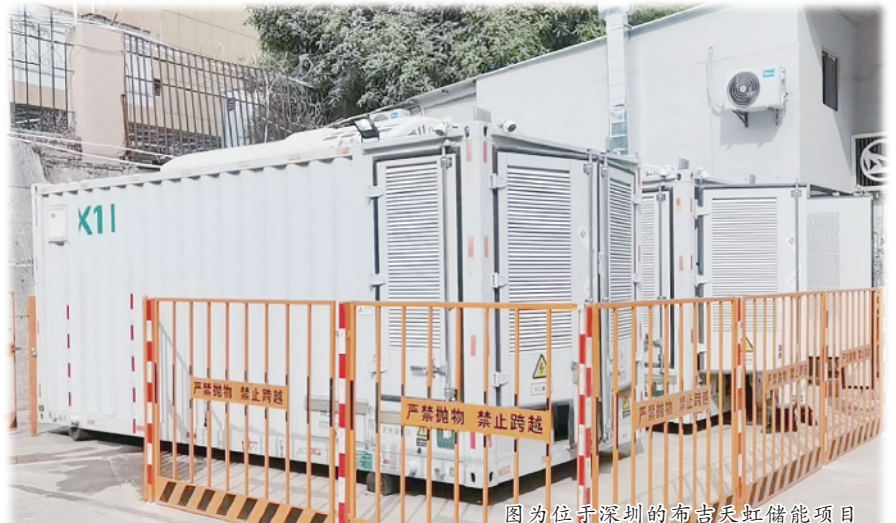
图为位于深圳的布吉天虹储能项目
