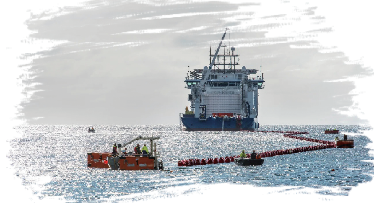
图为英国与丹麦共建的全球在建最长高压直流海底电缆工程“维京连线”的施工现场。
