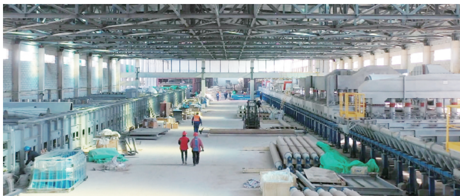
位于内蒙古准格尔经济开发区的总投资80亿元的玉晶科技优质特种玻璃综合利用一体化项目一期工程正在进行设备安装 王丽曼/摄
