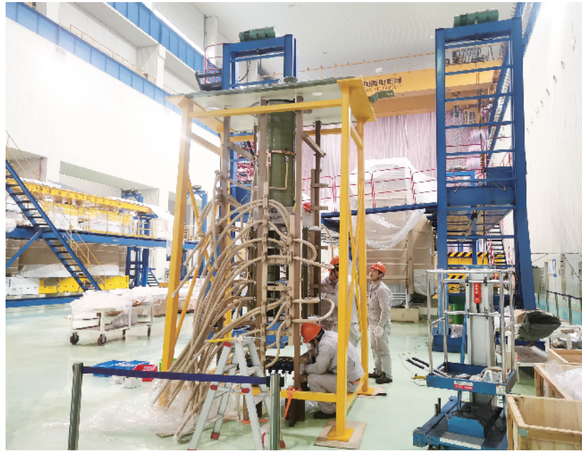
我国自主研发的换流变压器有载分接开关安装现场。袁湘湖/摄
