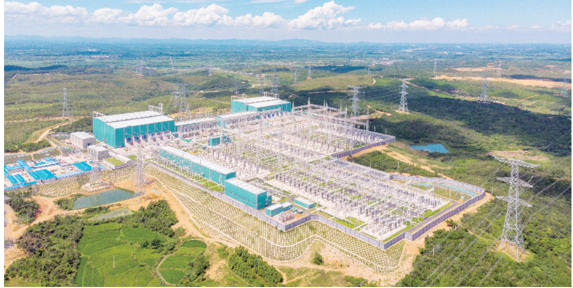
位于安徽宣城 的±1100千伏古泉换流站是新疆昌吉—安徽古泉±1100千伏特高压直流输电工程的受端站。该工程被誉为“世界四最”电网工程——世界电压等级最高、输送容量最大、输电距离最远、技术水平最先进。 全球能源互联网发展合作组织/图
