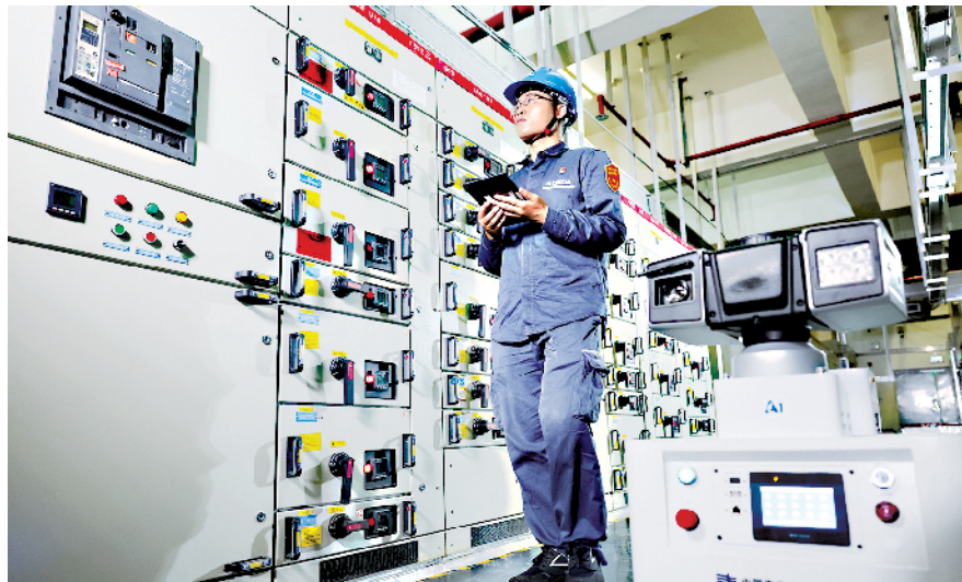
南方电网广西南宁供电局保电人员通过巡检机器人提升工作效率。 肖军/摄
