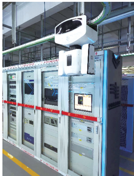
广州110千伏猎桥变电站内,运用轨道机器人进行智能巡视,实现站内无人值守。南方电网公司广东电网广州供电局/图
