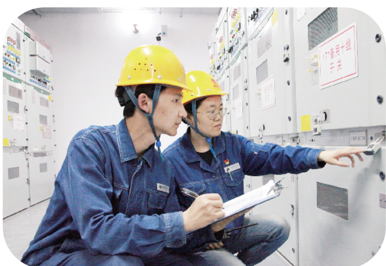
国网兰州供电公司变电运维人员对110千伏盐池变电站进行设备巡视。 火兴运/摄
