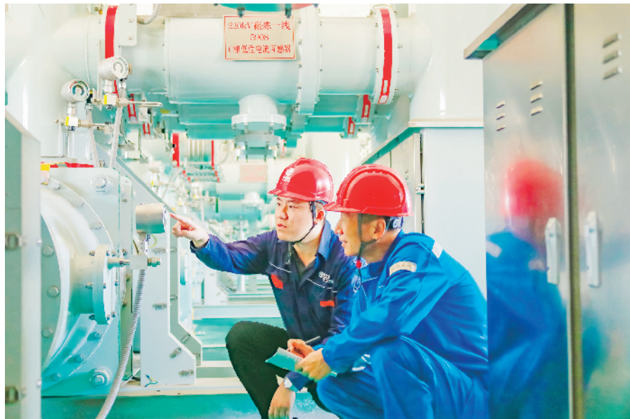
8月3日,在中石油锦西石化分公司220千伏双赢变电站内,国网葫芦岛供电公司员工指导帮扶运维人员提高安全用电和节约用电水平。李娇/图
