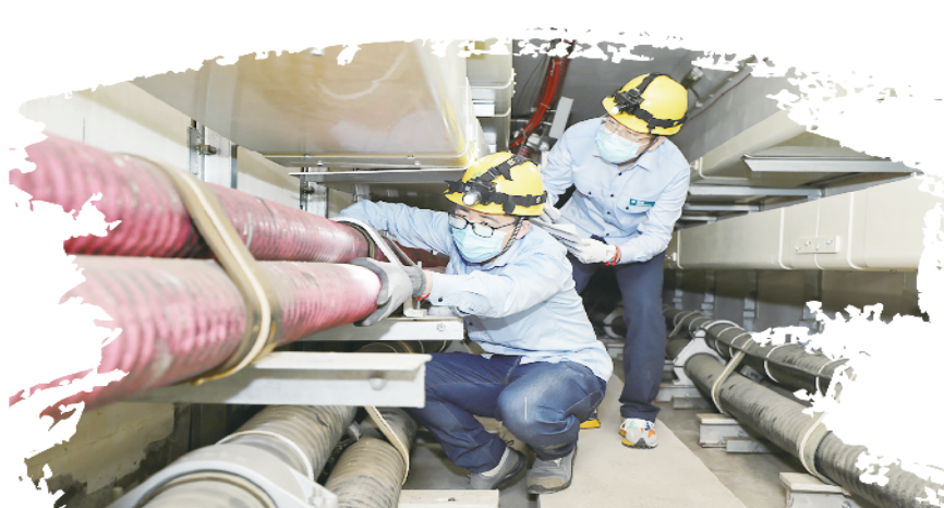
国网北京电力工作人员在隧道内对电缆线路开展巡视检测和精细化排,确保主网电缆安全可靠运行。 赵旌朝/摄
