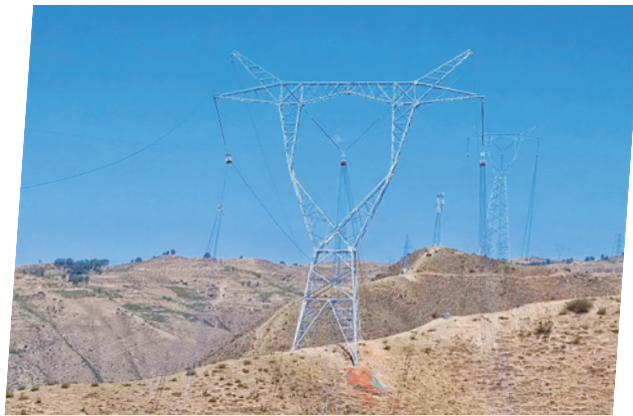
郭隆-武胜第三回 750 千伏输电线路工程(青海段)。 邹建华/摄
