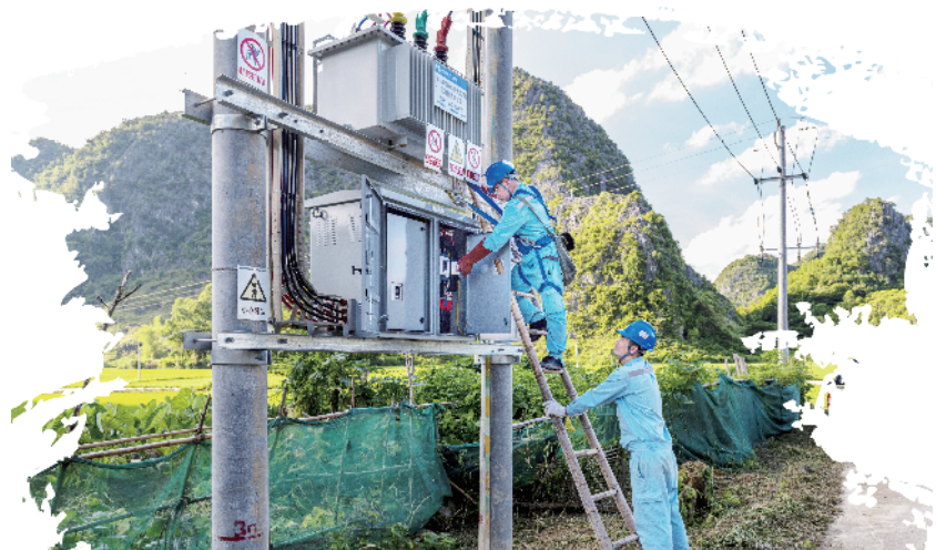
南方电网广西新电力集团靖西供电公司工作人员对鹅泉景区周边变压器进行日常巡视维护。
