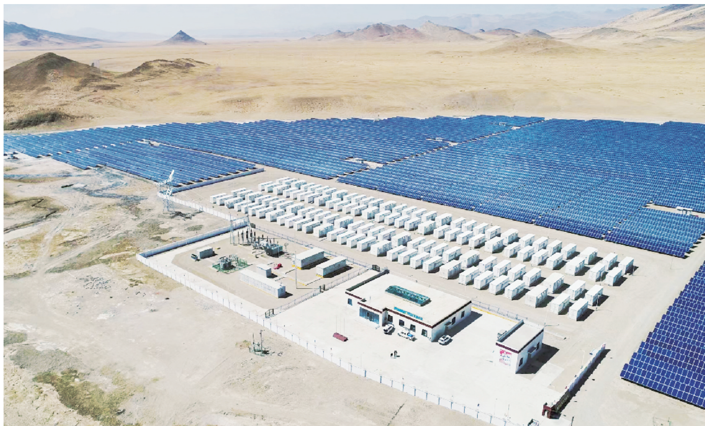
厦门科华数能西藏岗巴 40MW205MWh 光储项目。科华数能/图
