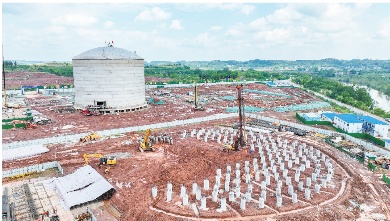
位于四川省遂宁市安居区的四川省重点民生工程——遂宁储气调峰基地，可储存 3 万立方米液化天然气，预计今年年底投入使用。
