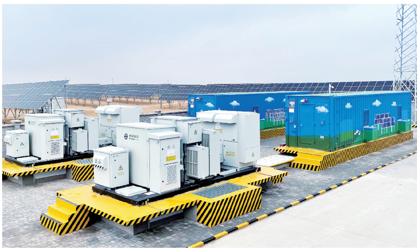
位于乌兰布和荒漠化防治科技创新示范基地的国华 100MWp 光伏治沙配套储能项目,采用远景能源智慧储能系统全栈解决方案。
