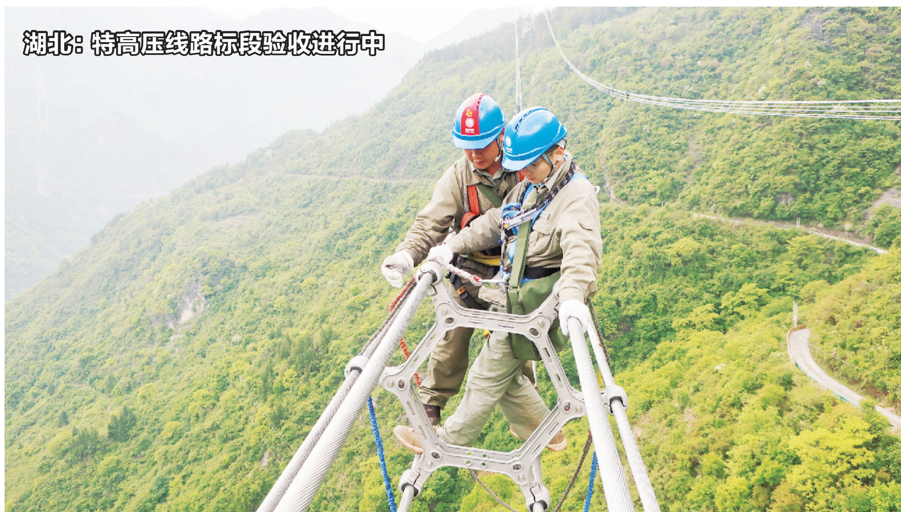
4月20日,国网湖北电力超高压公司宜昌运维分部对±800千伏白鹤滩-江苏特高压直流输电线路鄂5施工标段进行验收作业,运维人员克服山高路陡和阴雨天气,严把线路验收质量关,确保该工程如期送电成功。徐才宝/摄
