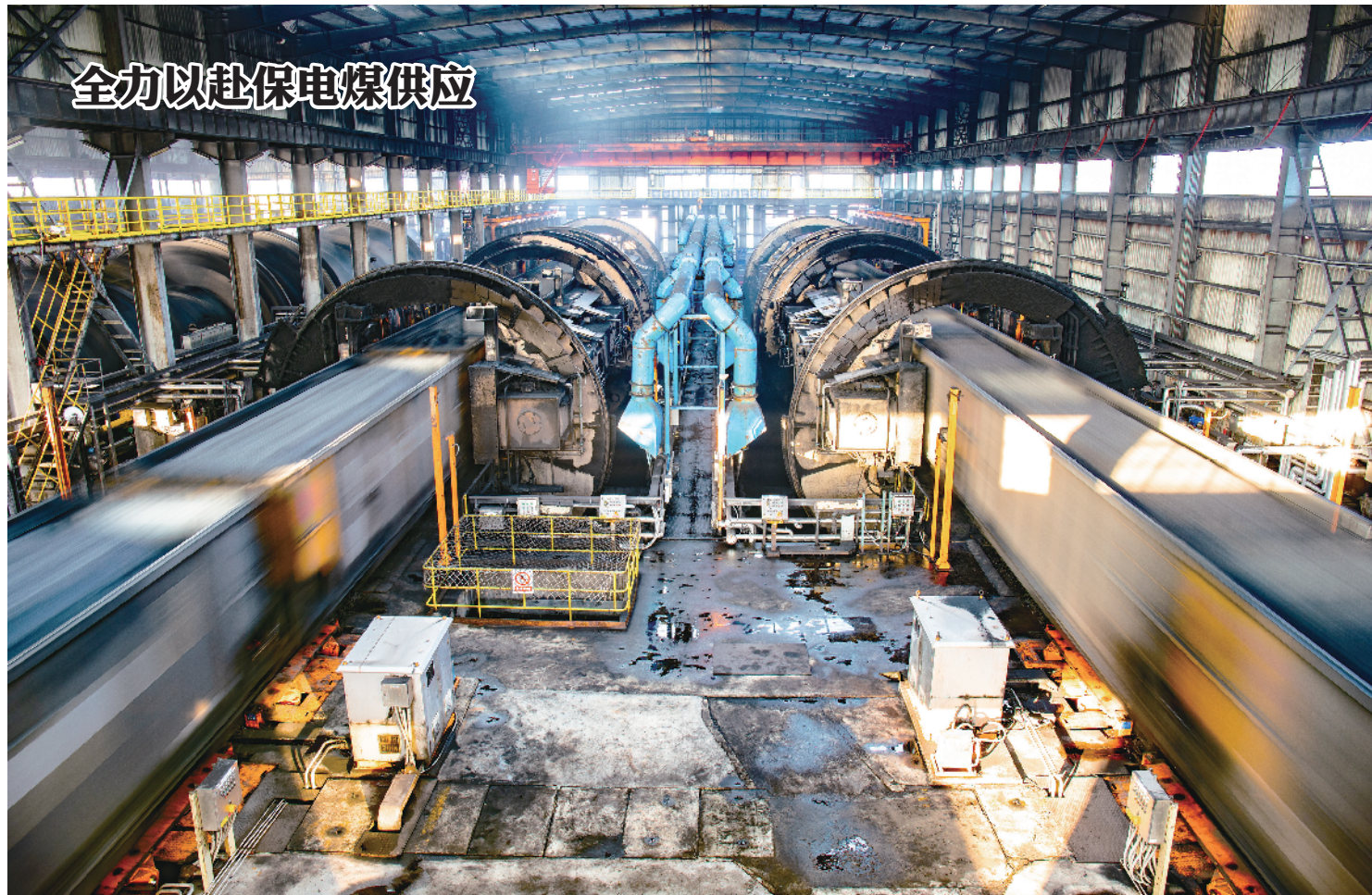
连日来,国家能源集团黄骅港务公司自觉扛起保供责任担当,在做好疫情防控和确保安全的前提下,科学制定运输计划,优化衔接流程,以日均卸车62万吨、装船63万吨的高效运输,全力以赴确保电煤供应。图为1月18日,黄骅港务公司翻车机正在接卸到港煤炭/摄 刘建玲/摄
