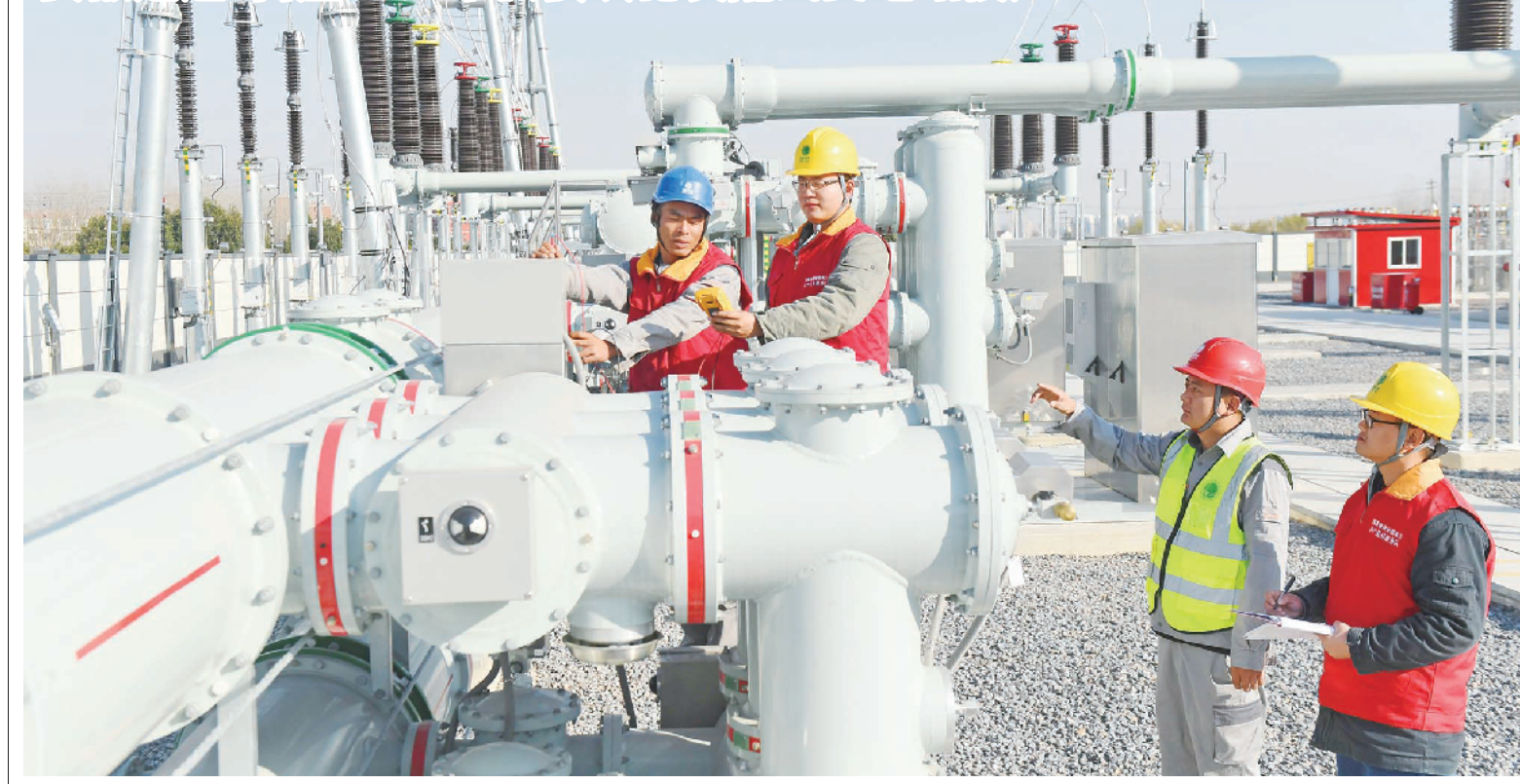
12月3日,在安徽省滁州市定远县光明村,安徽送变电工程有限公司和滁州供电公司技术人员正在对即将投产的220千伏鲁肃变电站进行设备调试。当日,安徽省滁州市定远县首座220千伏模块化装配式变电站在冬季用电高峰大负荷来临前竣工投产。 宋卫星/摄
