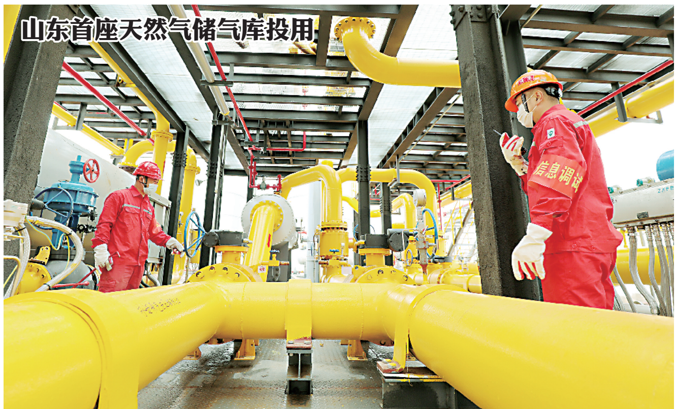
8月30日,山东省东营市永21储气库集注站内,中石化胜利油田员工王管和赵刚在工艺装置区进行巡检。据悉,永21储气库设计可利用库容2.38亿立方米,日调峰供气能力达198万立方米,是中石化百亿立方米储气调峰体系重点项目之一,也是在山东省建设的首座储气库。 王国章/图文
