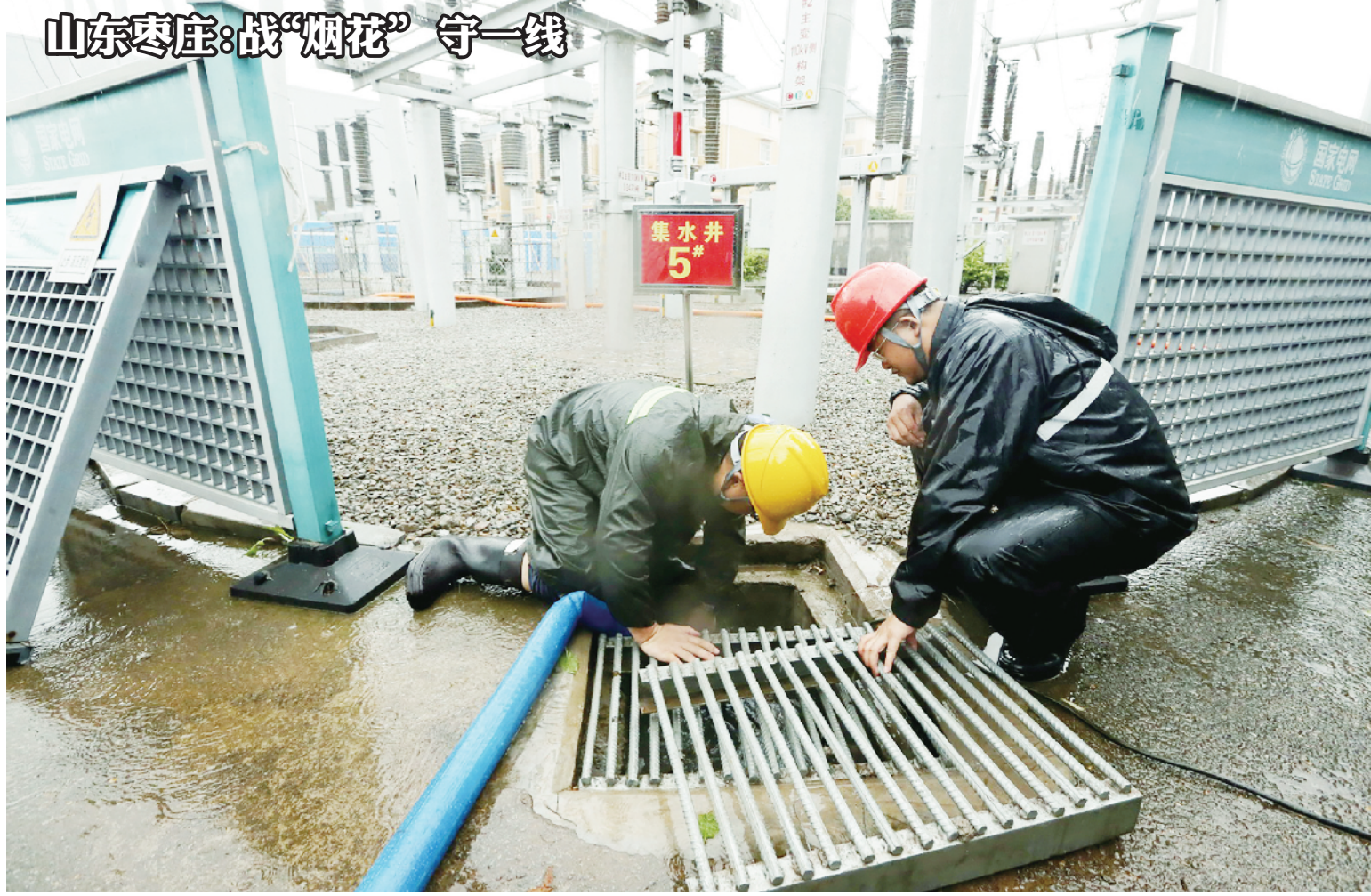
山东枣庄:战“烟花”守一线 峰城变电站建于1974年,历经半个世纪的风雨,站址由昔日的农村发展为现在的城区,整体低于四周地面1.5米,成为一个“大水坑”,也成为防汛抗台的重中之重。7月28日,山东枣庄供电公司在110千伏峰城变电站筑起沙袋墙,开启排水系统,备好大功率应急水泵,确保6号台风“烟花”过境时电网安全可靠运行。 鞠同心/摄
