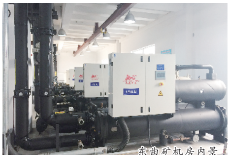
东曲矿机房内景
