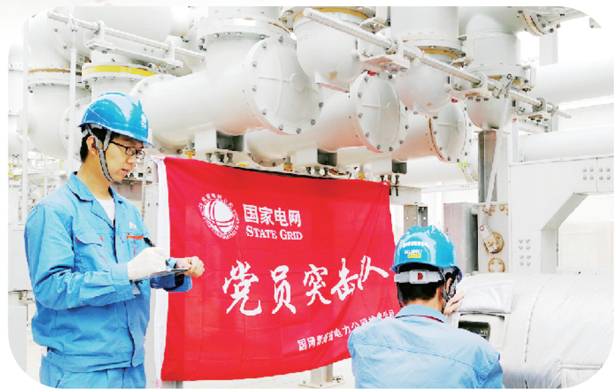
国网青海检修公司人员在±400千伏柴达木换流站检查GIS断路器机构箱。陈晓宁/摄
