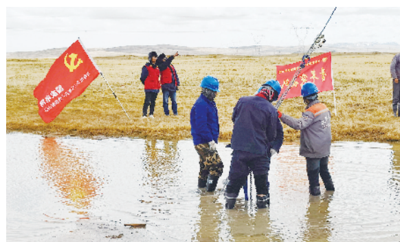
国网青海电力三江源(果洛)共产党员服务队对灾后受损线路进行消缺。徐文斌/摄
