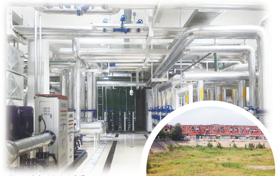
雄县人才家园换热站实景图
