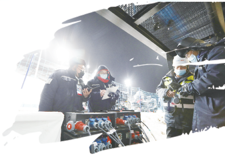
今年2月,冬奥会测试赛期间,张家口赛区保电人员在检查电气设备。
