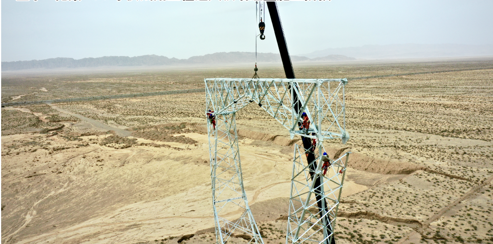
5月21日,由中国安能第二工程局承建的鱼卡-托素(德令哈)750千伏Ⅱ标段线路工程举行首基铁塔吊装仪式,标志着项目建设进入铁塔组立施工阶段。徐迎华/摄
