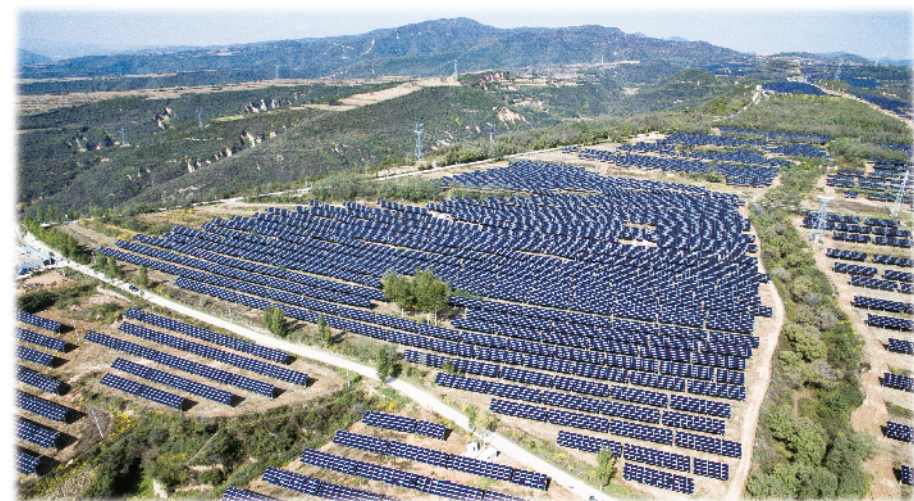
铜川光伏技术领跑基地宜君县映光250兆瓦光伏发电项目 于姗姗/摄
