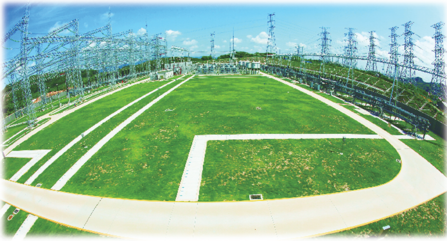
深圳供电局构筑了“相对独立，结构清晰”的局部坚强电网。图为500千伏紫荆变电站。赖增鹏/摄
