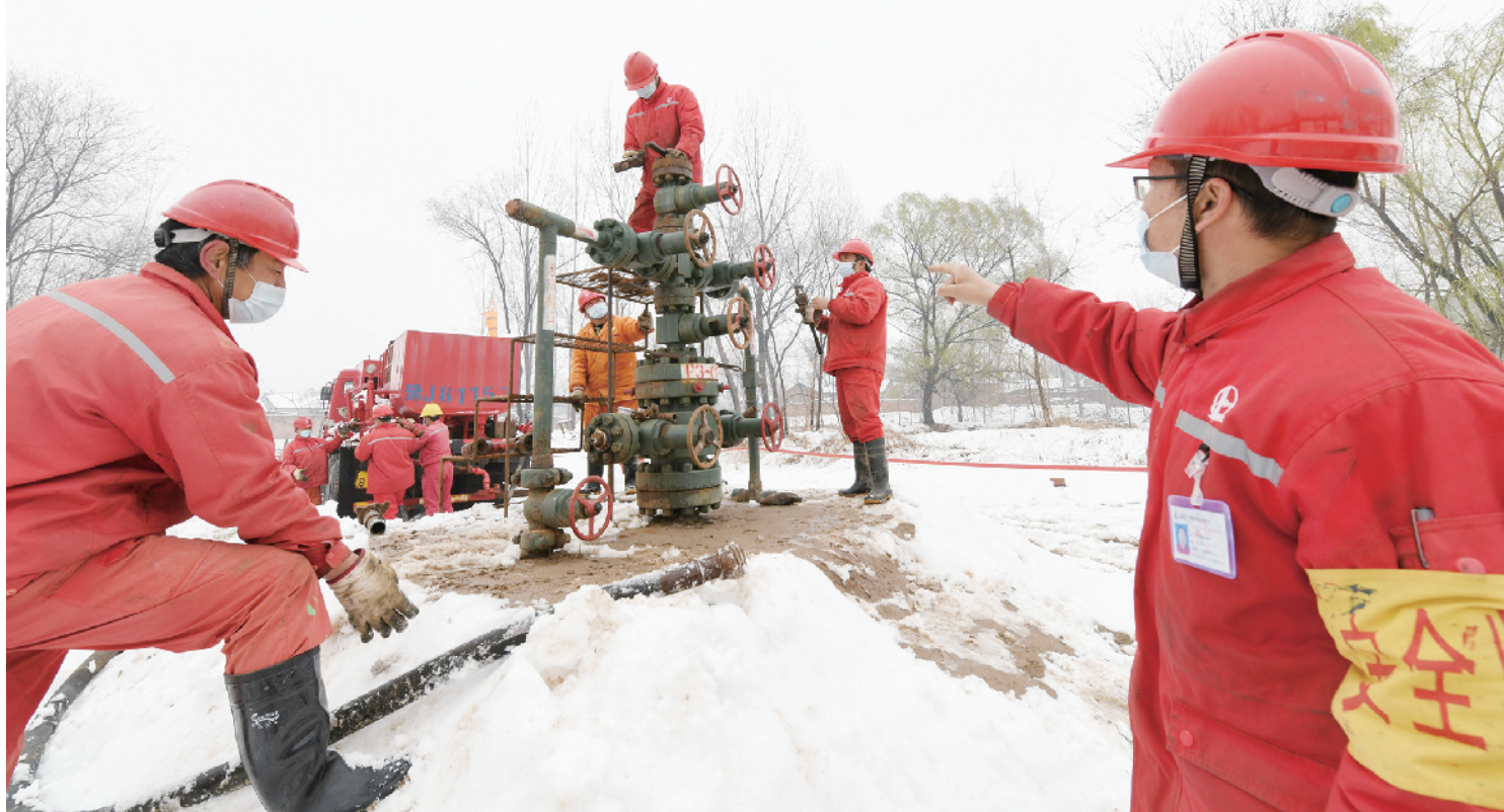
2月25日,一场春雪覆盖中原百里油田。为了消除天气影响,保障油气生产,中国石化中原油田濮城采油厂加大直接作业环节及承包商监管,规范资质审查、施工方案、开工手续等源头管理,抓好施工过程的检查与考核,抓实特殊天气时期的升级管理,严格执行干部带班制度,确保油气生产施工安全。图为2月25日,濮城采油厂干部员工在濮3-侧179井进行高压洗井施工。 赵奕松 王占标/摄
