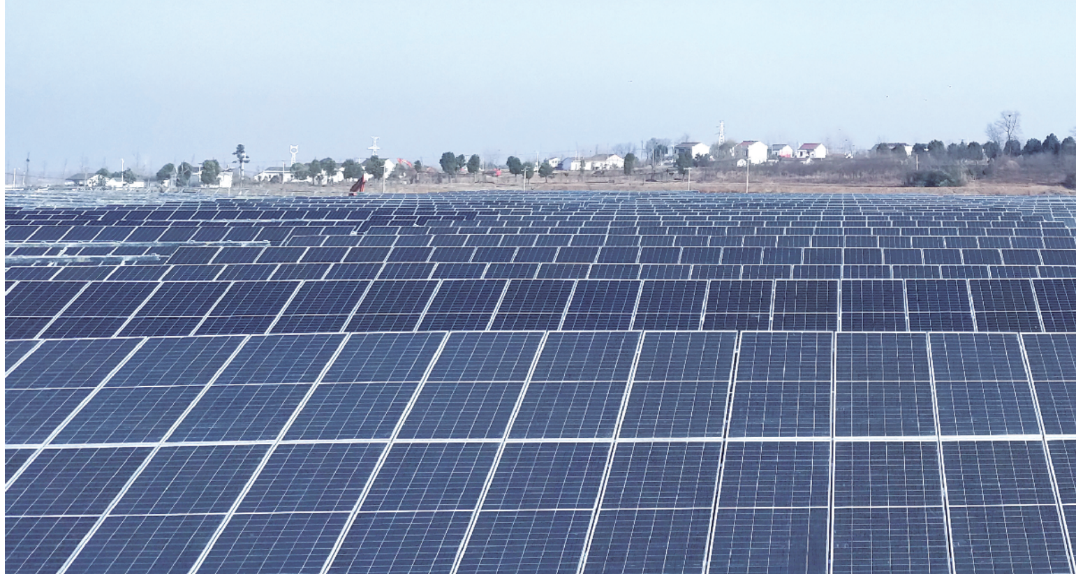
日前,西北建投承建的花园光伏发电项目并网发电。该项目位于安徽省霍邱县境内,计划投资2.57亿元,规划装机6万千瓦,主要由21个光伏发电单元构成,是集“光伏发电、花卉种植、农业科技实验、观光旅游”为一体的综合性“农光互补”光伏发电工程。 王志文/摄
