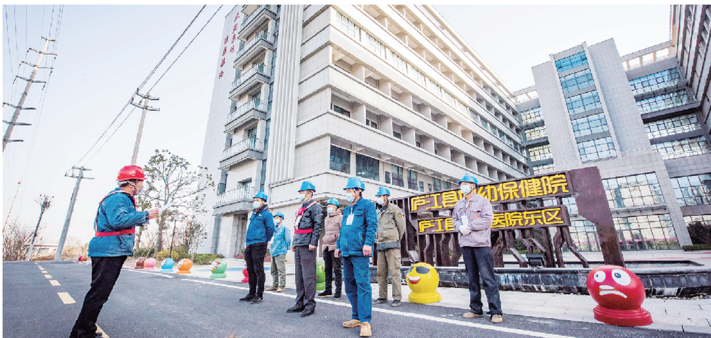
安徽庐江县供电公司员工在庐江县人民医院东区施工前召开班前会。丁文康/摄
