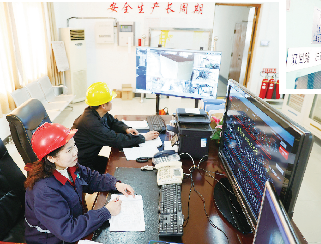
2月12日,淮能源集团煤业公司朱集东矿110KV变电所值班人员正在观察系统运行情况。
