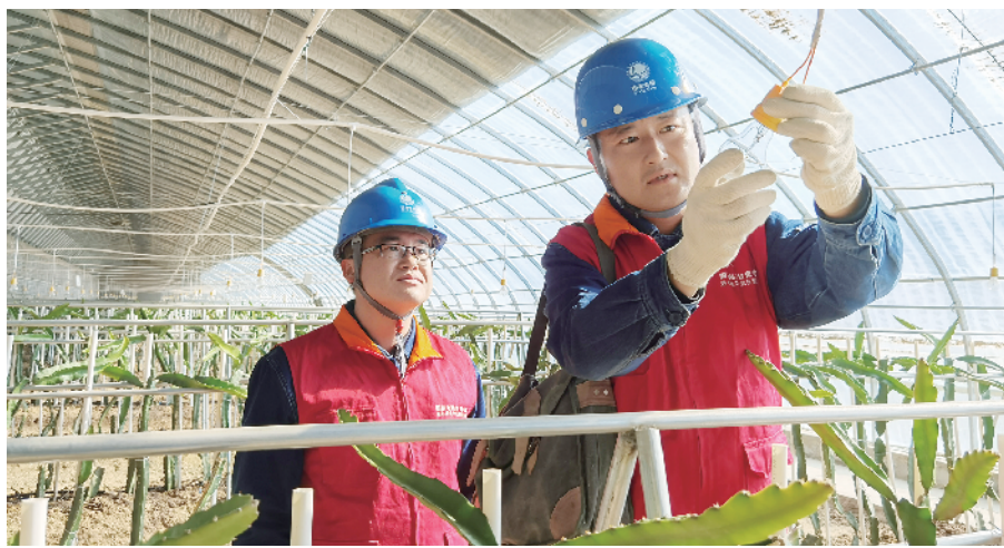
古浪县供电公司西靖供电所党员服务队检查大棚用电设备。杨鸿雁/摄
