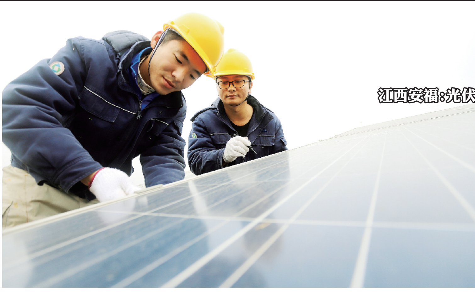
大郭村光伏电站是一座位于江西省吉安市安福县甘洛乡的大型山地光伏电站,装机容量20兆瓦,年发电量2400万度。寒冬时节,天气阴冷,该电站增加对光伏组件的“体检”次数,确保电站正常运转,巩固当地脱贫成果。图为12月13日,技术人员在检测光伏组件。 人民图片
