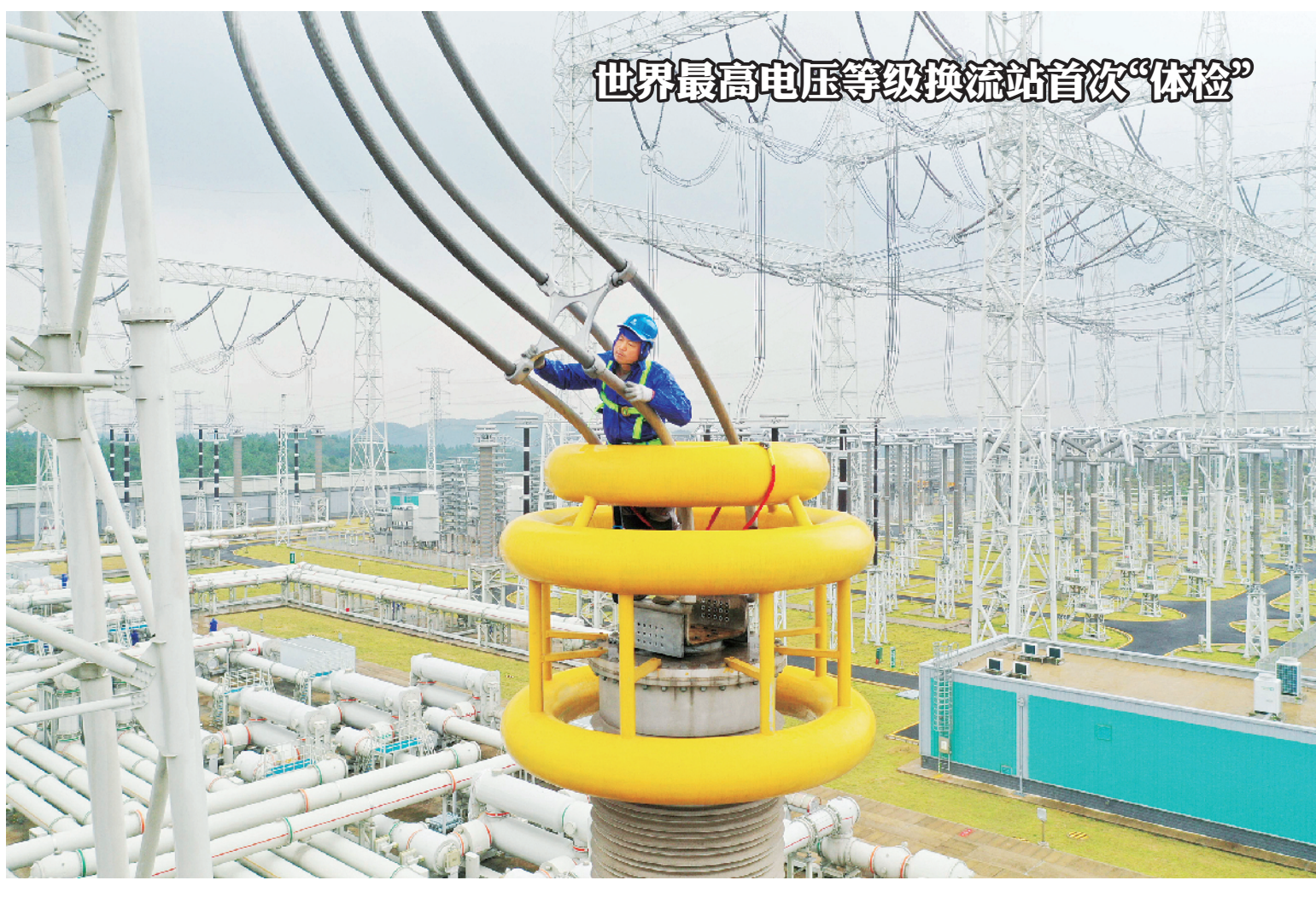
10月15日,在安徽省宣城市古泉镇,电力员工正在对世界上最高电压等级±1100千伏古泉换流站供电设备进行首次年度检修维护。 宋卫星 袁翔/图文
