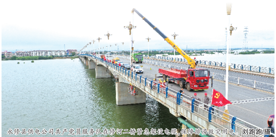
永修县供电公司共产党员服务队正在修河二桥紧急架设电缆,保障排涝救灾用电。刘跑跑/摄
