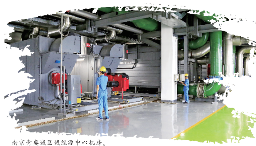
南京青奥城区域能源中心机房。
