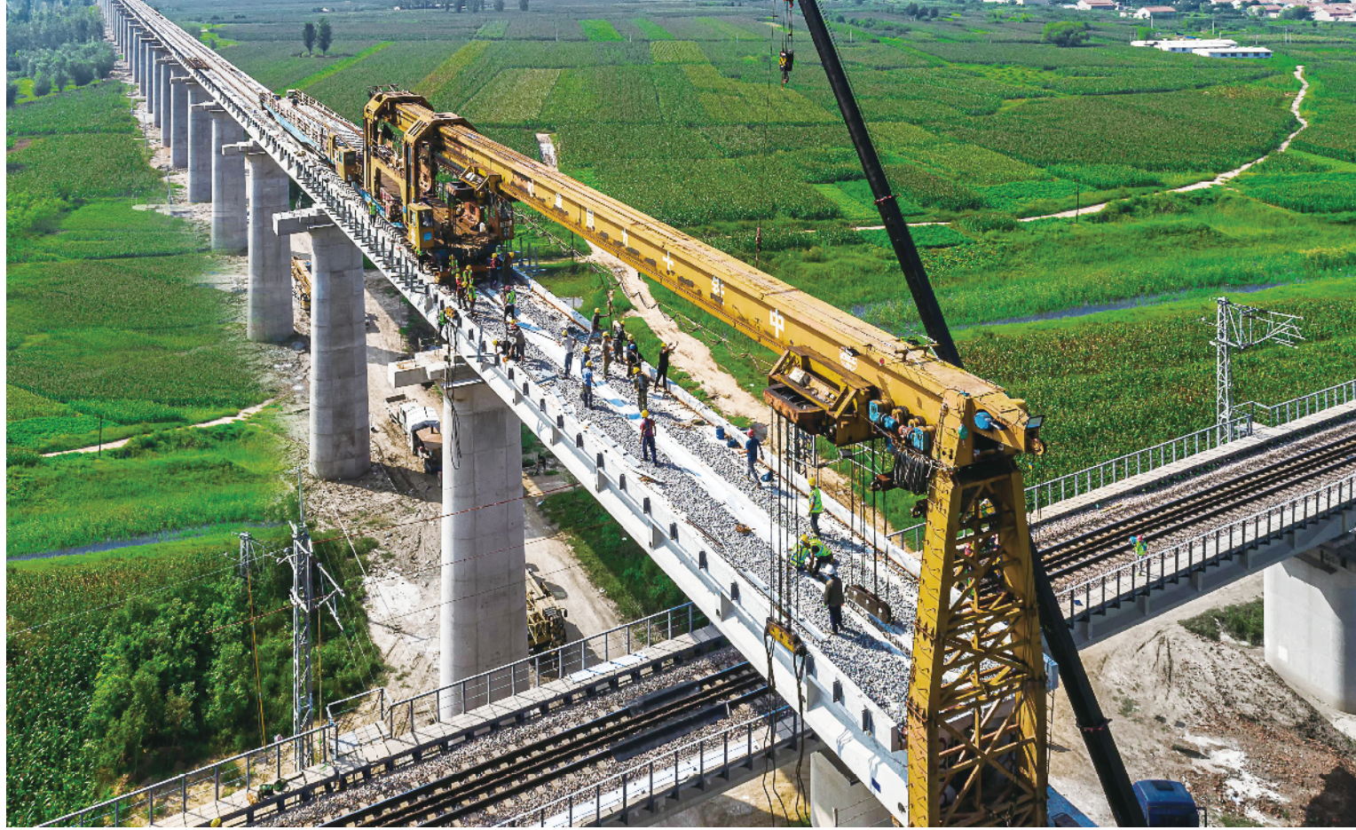
8月28日,黄大铁路海兴特大桥上跨邯黄铁路封锁架梁施工顺利完成,为年底全线开通奠定了坚实基础。黄大铁路是煤运北通道与胶济铁路的联络线,是环渤海铁路交通网的重要组成部分。海兴特大桥全长16.2千米,本次施工地点位于河北省海兴县小曲河村,该跨与既有邯黄铁路夹角为87度。图为黄大铁路上跨邯黄铁路施工现场。刘亚奇/摄
