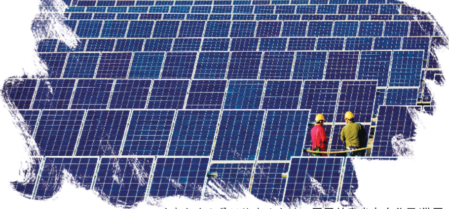
甘肃电力人员巡检光伏电站。国网甘肃省电力公司/供图
