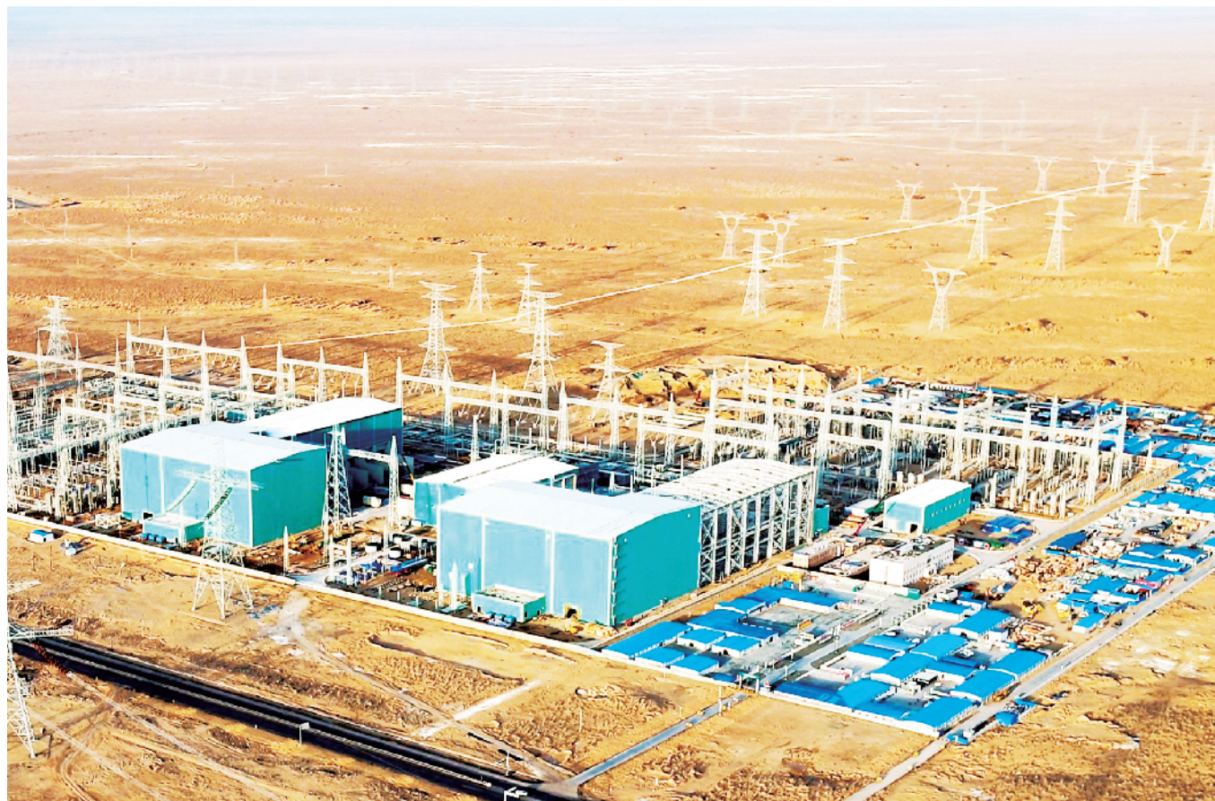
新疆准东(昌吉)-安徽皖南(古泉)±1100千伏特高压直流工程(吉泉线)昌吉换流站全景。吉泉线是“疆电外送”重要通道,世界电压等级最高的输电工程。 刘文龙/摄
