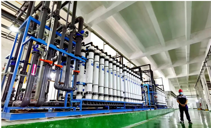
广东银瓶山工业园污水处理中心内部景观。章柯摄
