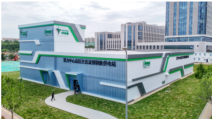
近日,特锐德自主研发的全球首创算力中心高压交直流预制舱供电站(算电岛)在山东省青岛市崂山区发布。产品重构算力电力底层架构,依托全产业链自研、工厂模块化预制模式,凭借快、新、智、绿、省、稳六大核心优势,大幅压缩建设工期、降低能耗与造价,以国产化电力技术破解行业供电难题,助力AI算力产业突破能源瓶颈。
